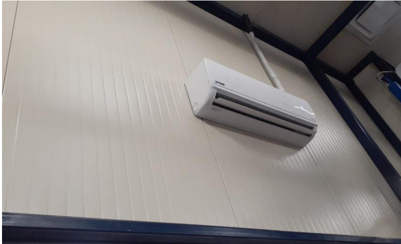
Ilustración 46 Aire acondicionado implementado
